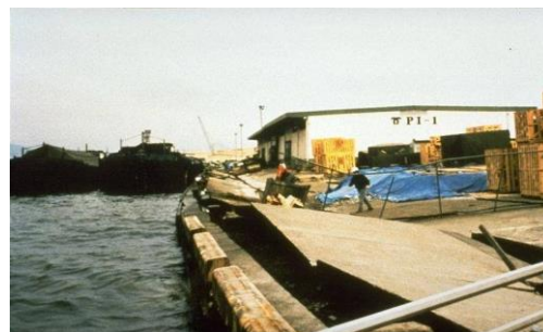
Hình 2. Bến cảng Kobe phần tường chắn bị hư hại
