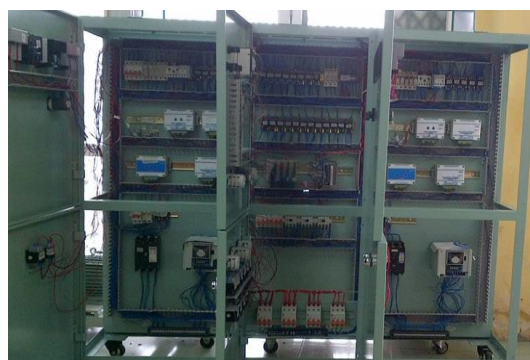
Hình 4. Bên trong mô hình trạm phát điện tàu thủy
